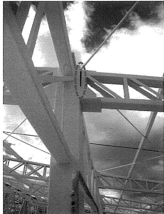
Fotografía N° 3. Eje A-10 (Lado posterior de la foto N° 8): Estructura no se encuentra a tope, con sección vertical de unión sin soldar.
